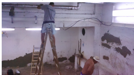
Od septembra bude základná škola vykurovať všetky priestory a ohrievať teplú vodu za pomoci nových plynových kotlov a vykurovacieho systému.
